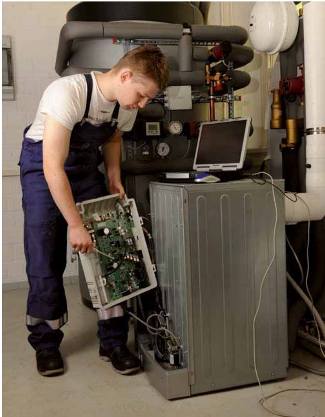
Auch mit der Mikro-KWK-Anlage WhisperGen wird Strom kostenlos im Keller erzeugt.
